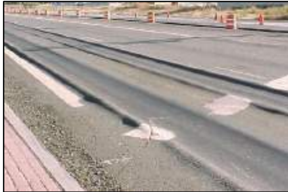
Gambar 2.12 Kerusakan Alur ( Rutting )
