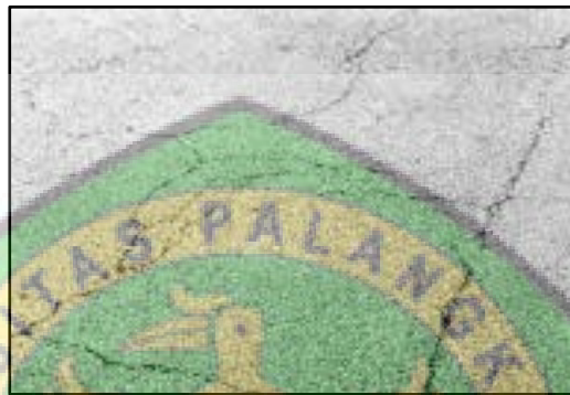
Gambar 2.4 Retak Blok ( Block Crack )
